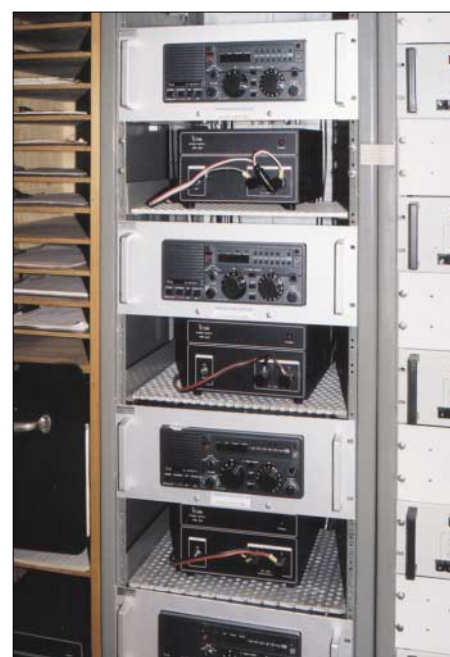
Vier Transceiver IC-M700TY von Icom kommen bei der Ansteuerung der 10-kW-Endstufen zum Einsatz – die Endstufen selbst stammen von Collins. Fotos: Roleder
